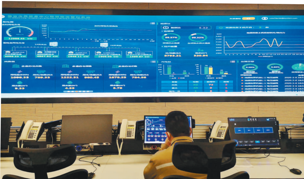
雄安新区市民服务中心智慧能源管控系统。
